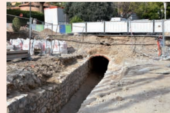
Le vallon de la Muerta a été mis au jour à l'occasion des travaux. Cet ouvrage d'eaux pluviales extraordinaire a beaucoup fait parler de lui dans Beaulieu !
