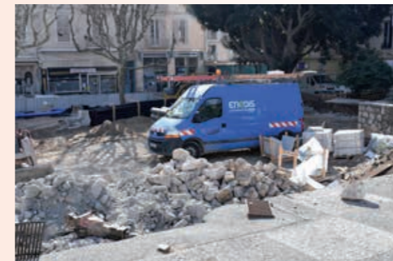
Tous les réseaux ont été refaits à neuf : électricité, alimentation en eau, évacuation des eaux usées et eaux pluviales, éclairage public, réseau de vidéoprotection.
